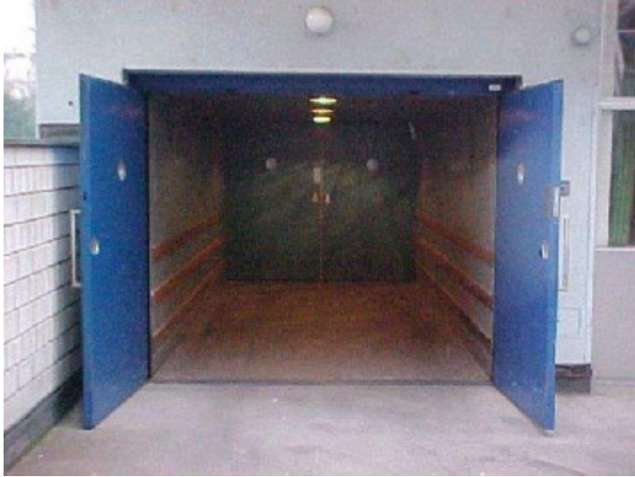
Warenlift, Riehenstr. 74, 4058 Basel
